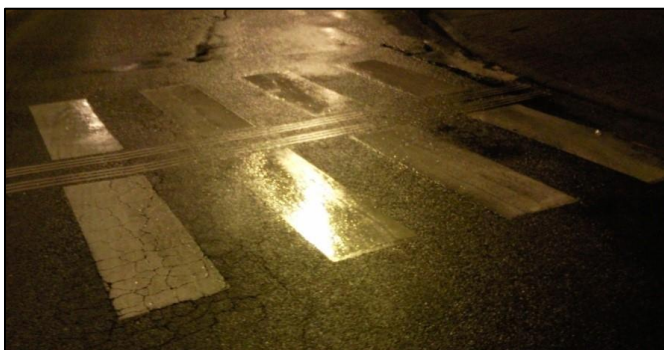
Fotografie dokládá vysokým leskem nebezpečně kluzký povrch značení přechodu pro chodce.
